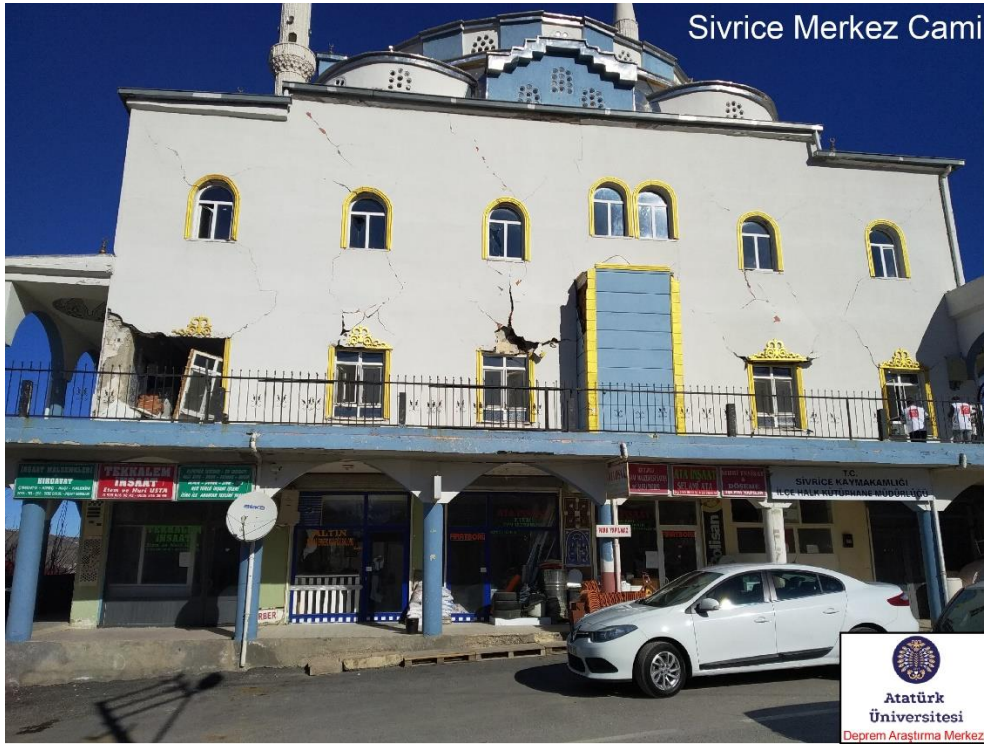
Şekil 13: Elazığ Sivrice Merkez Cami Hasar Sonrası dış görünüm
